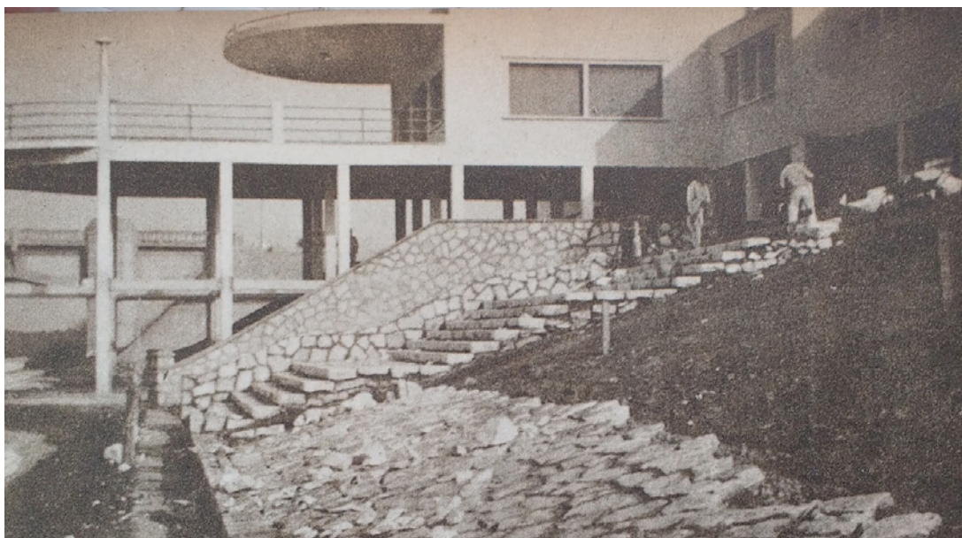
Figura 6. Vista de las obras de construcción del edificio del balneario- Cuatro años de gobierno. Tomo V Hidráulica. Pavimentación. Obras Sanitarias. Geodesia y Catastro.
