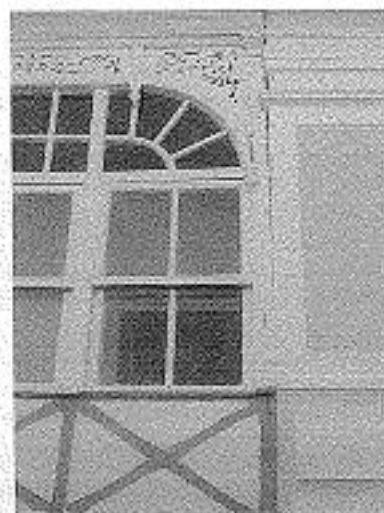
Fig. 4. Residência do Conde de Moreira Lima, Lorena, SP. Detalhe do encontro de duas técnicas: à direita, o edifício original em taipa de pilão; à esquerda, fechamento da varanda em estrutura de madeira, de gosto eclético.
