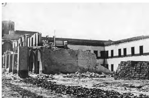
Figura 5: Demolición del Cabildo (por detrás, a la izquierda, se observa la torre de la Jefatura de Policía, 1908). Colección particular Lic. Graciela Hornia, AGPSF.
